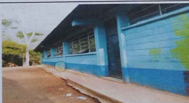
Foto 4: Se observa el deterioro del corredor del aula del modulo 1.
