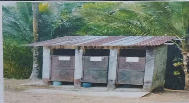
Foto 1: Se observa el deterioro y inestabilidad de los baños.
